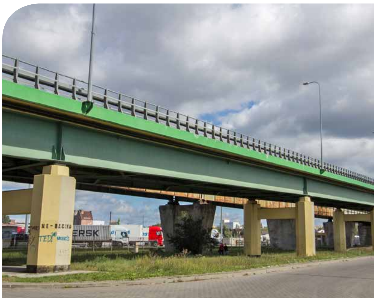
Most wymaga natychmiastowego remontu! fot. Adam Mastalerz
